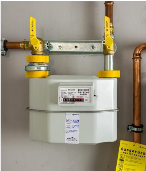
Abbildung 8: Balngaszähler mit Zählerregler
